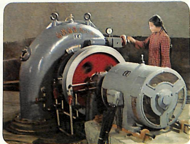
山村的电站内，安装了水轮发电机。
