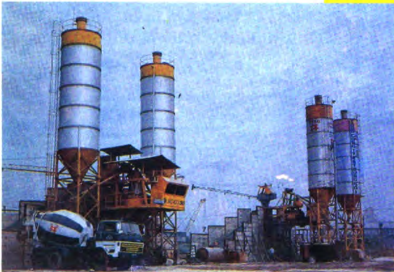
■ Trạm trộn bê tông công suất 70\text{m}^3/\text{giờ}
